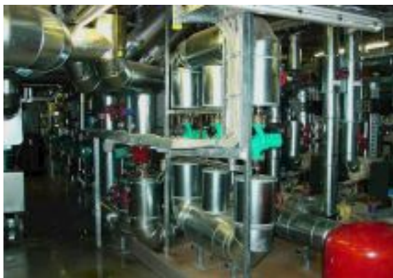
Rashladno postrojenje Medicinski institut Dizeldorf, Nemačka
