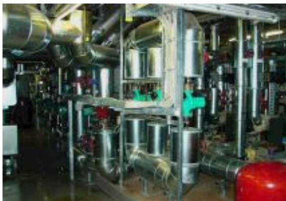
Rashladno postrojenje Medicinski institut Dizeldorf, Nemačka
