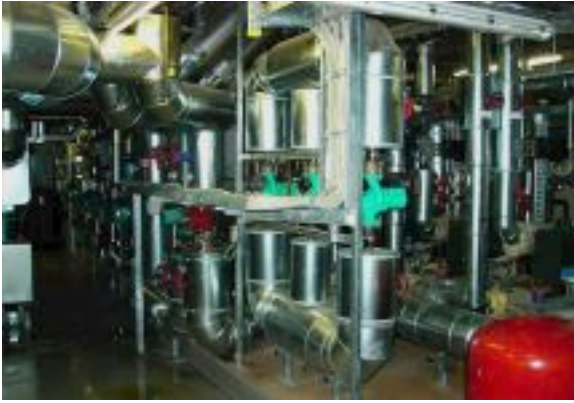
Rashladno postrojenje Medicinski institut Dizeldorf, Nemačka Zoom
